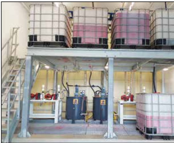
Автоматический узел подготовки раствора
